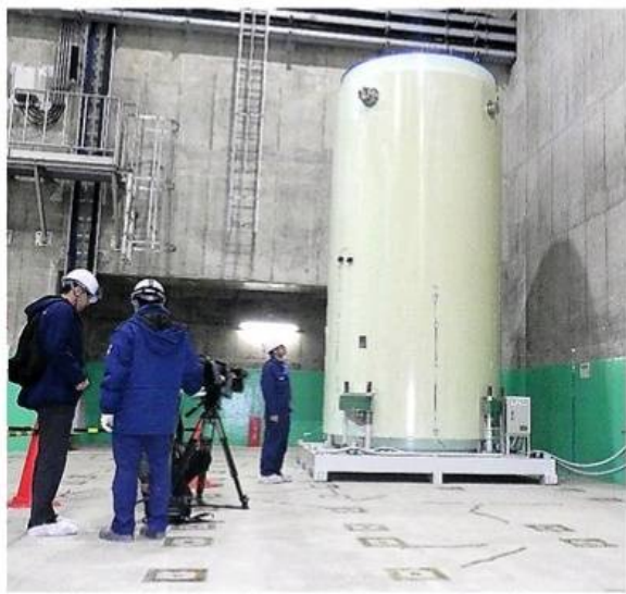
貯蔵建屋内に据え付けられた、使用済み核燃料の入った金属製の専用容器＝むつ市
